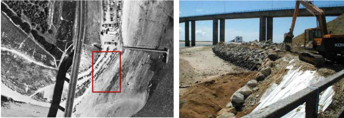
Figure 6.116 : Perré prolongé au sud de l'estacade : photo aérienne de mai 1989 (Géoportail), à gauche, et photographie des travaux de reprise en 2000.
