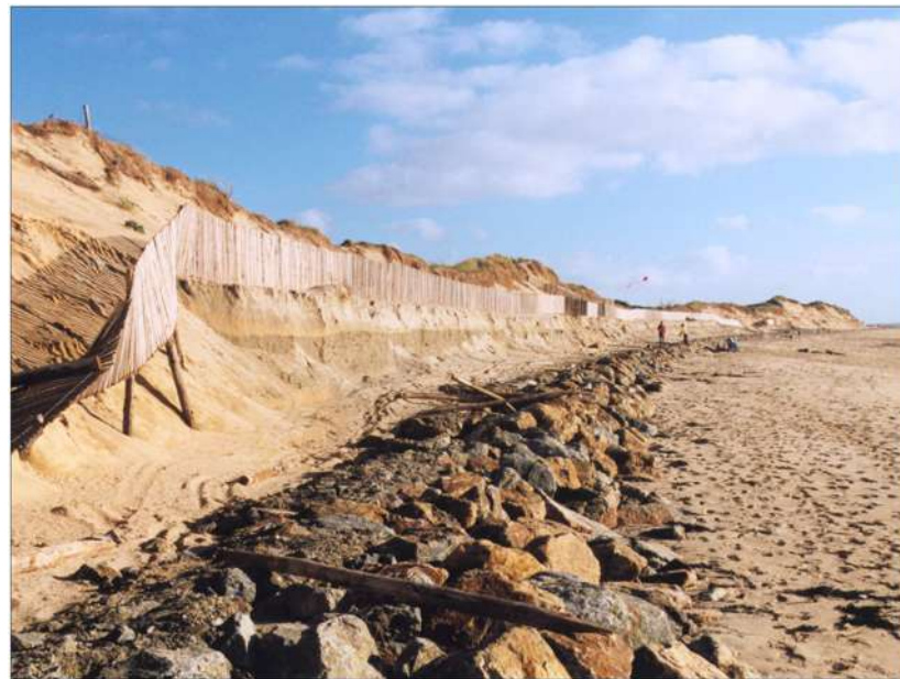
Figure 6.96 : Etat du perré bas des Eloux en octobre 1999.
